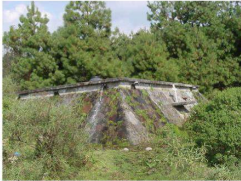
RED DE AGUA POTABLE TANQUE CON CAPACIDAD DE 107,000 LITROS, 1,000 TOMAS DOMESTICAS
