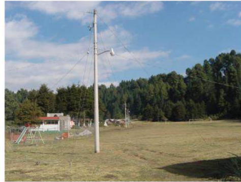
LINEA DE ENERGIA ELECTRICA 10 TRANSFORMADORES, CAPACIDAD 100 CASAS HABITACION
